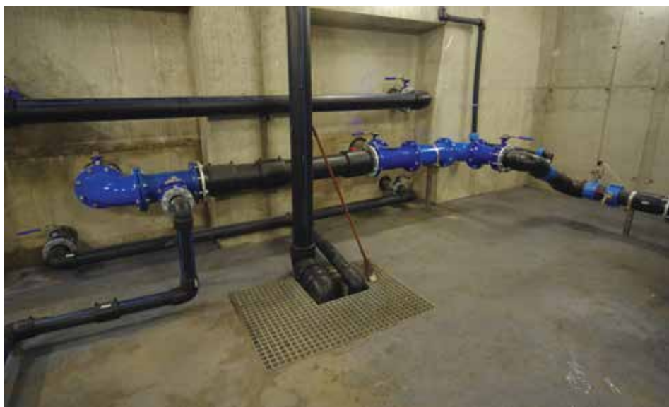
Provozní část vodojemu. Skupinový vodovod svazku obcí TřeMoLe již začal sloužit obyvatelům obcí, které se donedávna potýkaly s nedostatkem pitné vody
