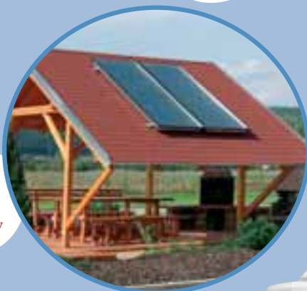
solární systémy kolektory
